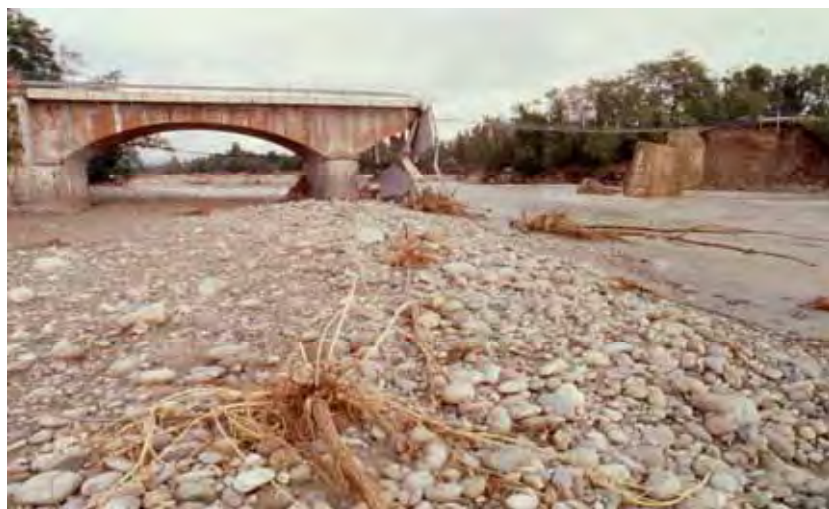
Fig. 38 - In occasione delle piene eccezionali si verificano crolli dei ponti in seguito alla spinta delle acque il cui carico solido (pietre, massi, tronchi d’albero e detriti vari) agisce sulle strutture di sostegno demolendole. In molti casi invece la causa principale dei crolli è l’insufficiente dimensionamento delle “luci”, le cui superfici dovrebbero essere valutate per eventi caratterizzati da tempi di ritorno fino a 500 anni; ma tenere conto di ciò significa costi molto elevati. Si finisce così con lo spendere di più per la ricostruzione. In ogni caso è bene mettere in evidenza che non esiste un ponte sicuro al 100 %. In
