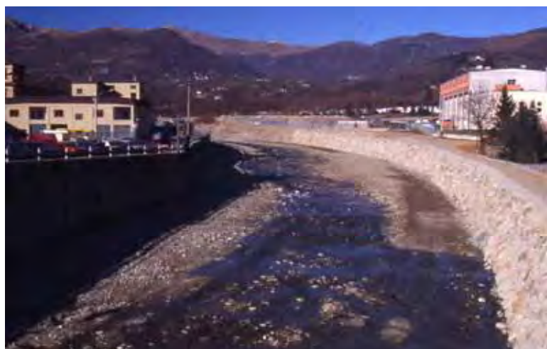
Fig. 11 - Per proteggere le case, le sponde sono state "sistemate" con pareti lisce, per diminuire la loro capacità di opporsi, per attrito, al flusso dell'acqua. Ma la corrente, durante le piene, diventa più veloce e più pericolosa, verso valle, per l'incremento della energia erosiva.
